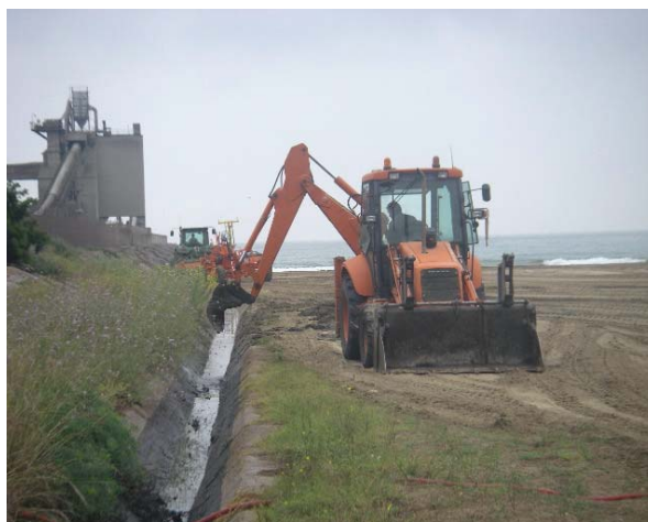
Neteja de la xarxa de pluvials a la platja de la Fàbrica de Ciment, a Alcanar (09-06-2010)
