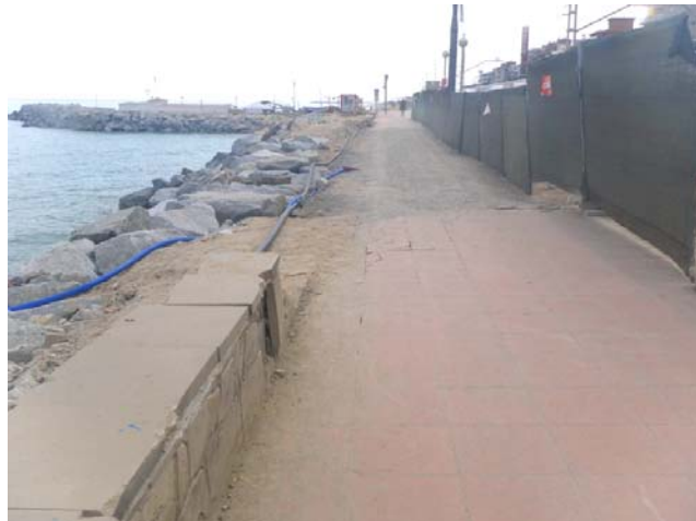
Tram del passeig tallat per les obres d'instal·lació d'ascensors a Vilassar de Mar (09-07-2010)
