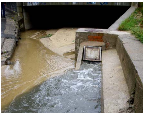
Barreja de les aigües de pluja que baixen per la riera i les residuals que surten pel sobreixidor a la platja de Malgrat de Mar (17-09-2010)
