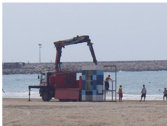
Instal·lació de la caseta dels socorristes a la platja de Ribes Roges a Vilanova i la Geltrú (08-06-2010)
