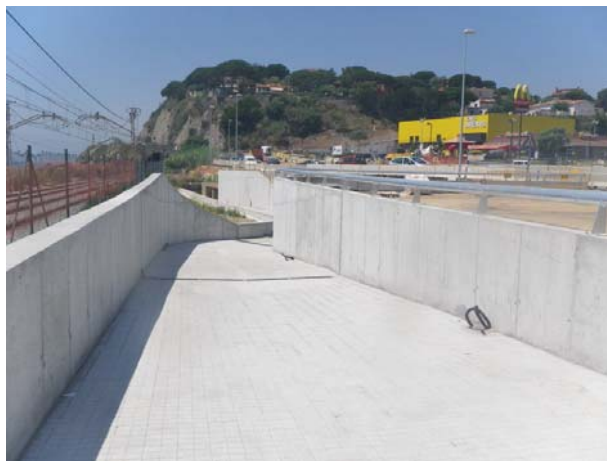
Construcció d'un pas soterrat a la platja de les Roques d'en Lluc, a Arenys de Mar (01-07-2010)
