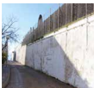
▲ El mur del cementiri s'ha de reformar
