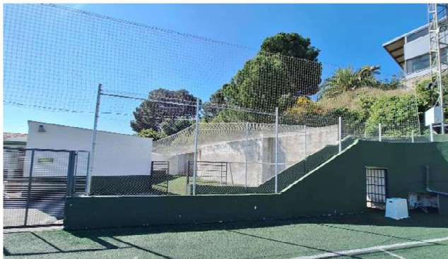
Xarxes i malla de protecció a substituir
