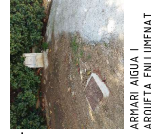
ARMARI AIGUA I ARQUETA ENLLUMENAT
