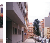
15. Col·locació de més bancs i arbres al carrer de les Doedes. 24.500 euros
